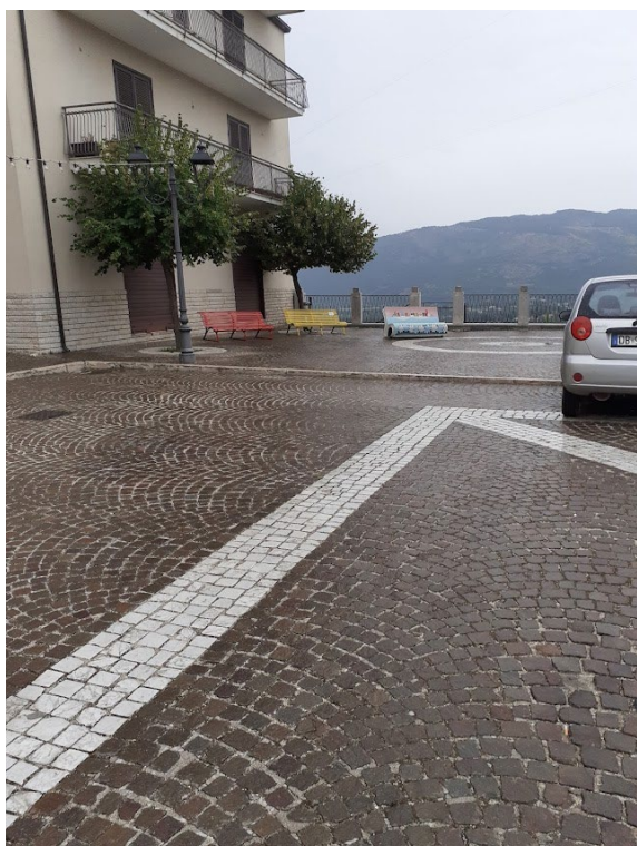
Fot. 4 Marciapiede senza rampa.
