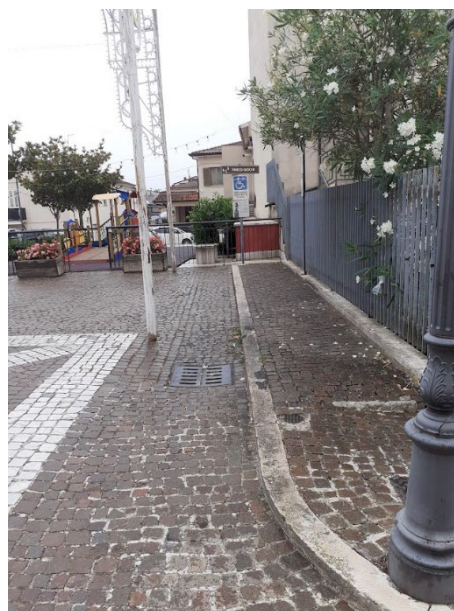
Fot. 3 Marciapiede privo di rampa inclinata
